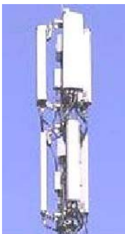
esempi di accorpamento di antenne per stazione radio base con collocazione a basso impatto visivo/ambientale (antenne molto ravvicinate al supporto)
