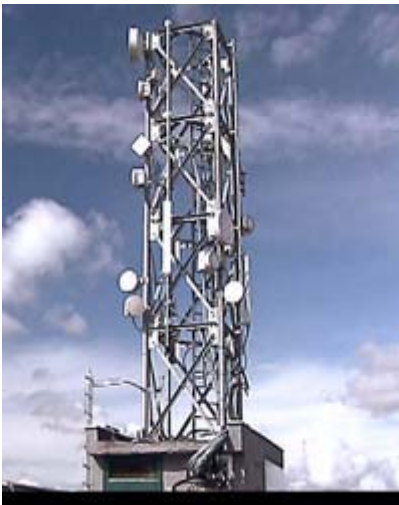
esempi di installazione di antenne per stazione radio base ad elevato impatto visivo/ambientale realizzate senza tener conto di alcuna mitigazione e contraria ai principi di questo regolamento
